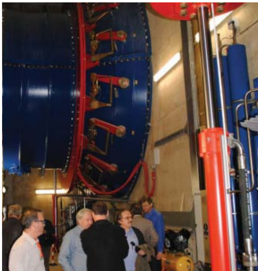
Pohled na oběžné kolo elektrárny ve Štětí
